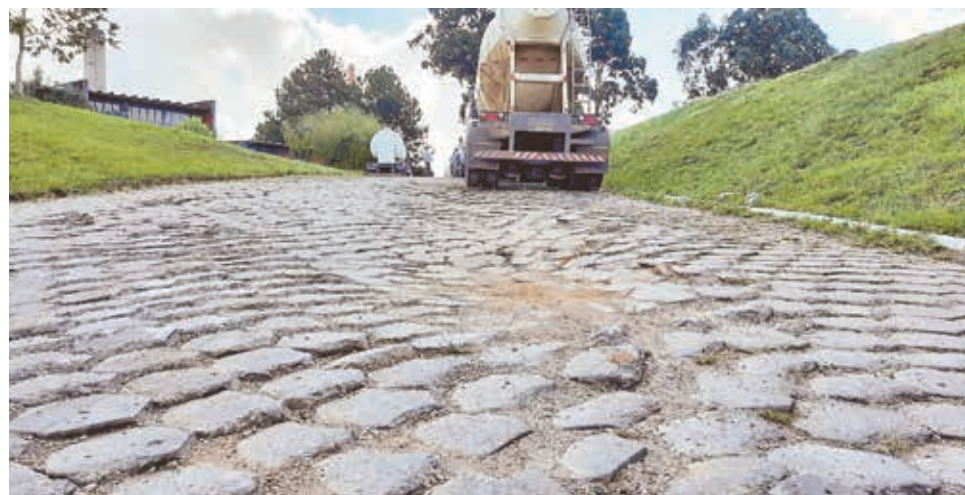
Entrada do CTG Candeeiro do Pago está com desníveis grandes pelo trânsito pesado
