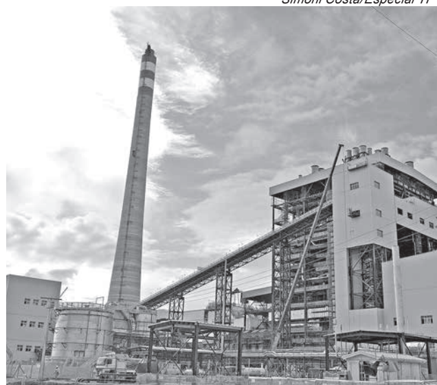
Unidade possui capacidade de geração de energia para atender cerca de 1,3 milhão de pessoas
