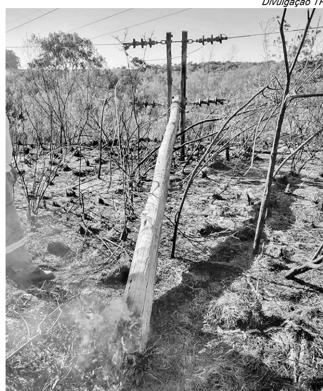
Postes de energia elétrica foram destruídos pelo incêndio
