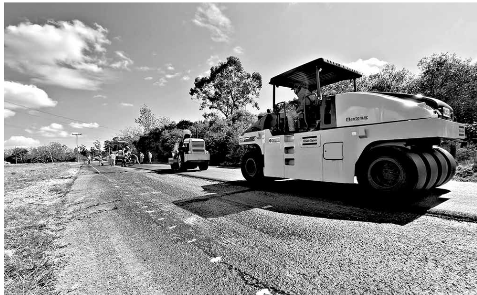
A principal via de acesso a Candiota foi revitalizada totalmente há menos de um ano e já possui trechos deteriorados
