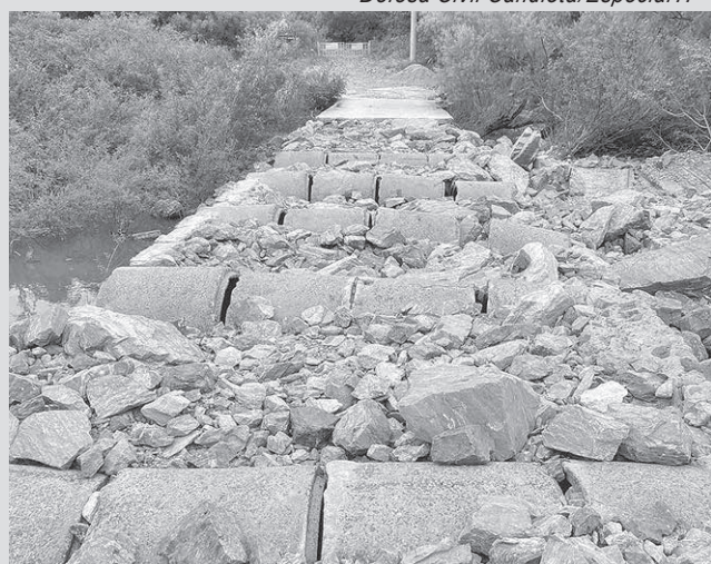
Estrutura foi levada pela água
