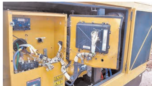
Gerador que garante a captação e bombeamento da água bruta em caso de falta de energia, também sofreu depredação
